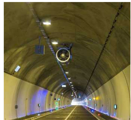
Sicher durch den Tunnel dank Überspannungsschutz
